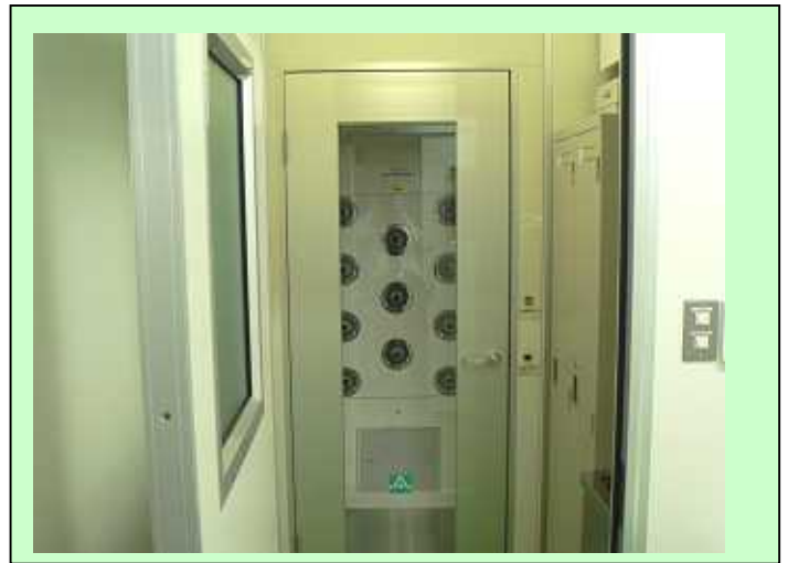
エアシャワー(室外からの埃等を除去)
